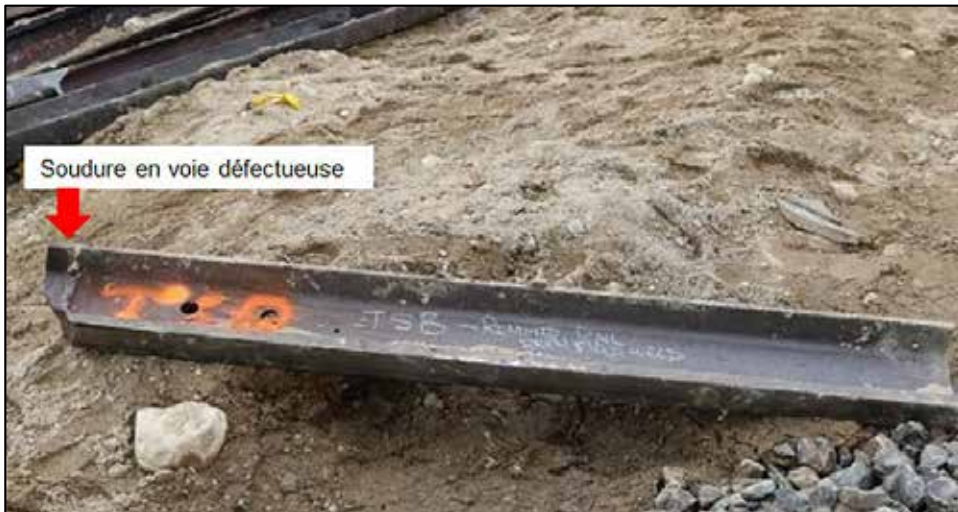
Figure 5. Section de rail de 68 pouces présentant une soudure en voie défectueuse
