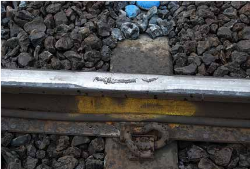
Figure 12. Exemple d'affaissement localisé de la surface de roulement
