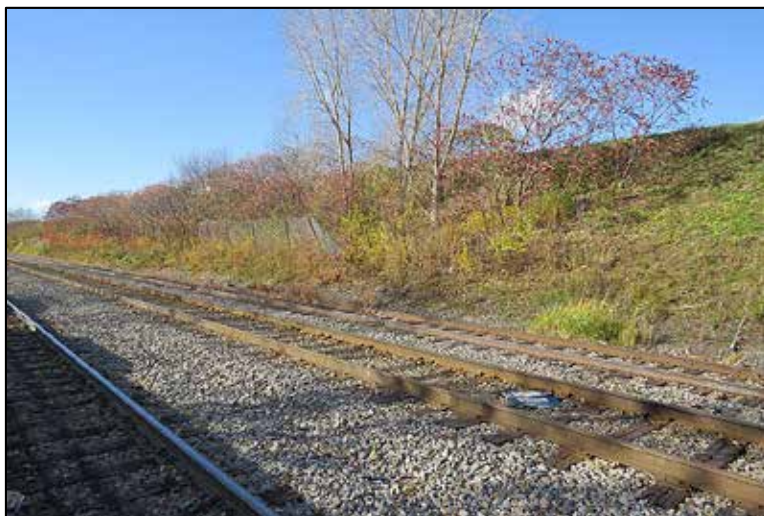
Photo 6. Clôture mal entretenue ou manquante
