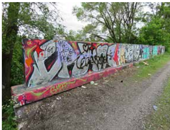
Photo 8. Graffitis sur les parapets des ponts
