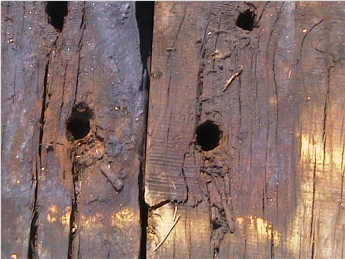
Photo 4. Trous de crampon détériorés dans les traverses
