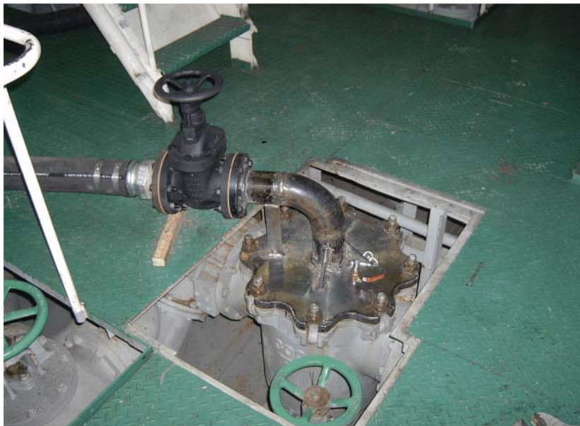
Photo 4. Tuyauterie temporaire reliée à la crépine de la prise d'eau de mer, renvoyant directement l'eau de refroidissement de la machine principale au coffre de prise d'eau.
