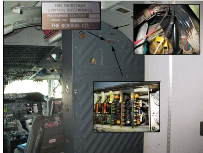
Photo 1. Dommages causés par l'incendie au panneau P6
