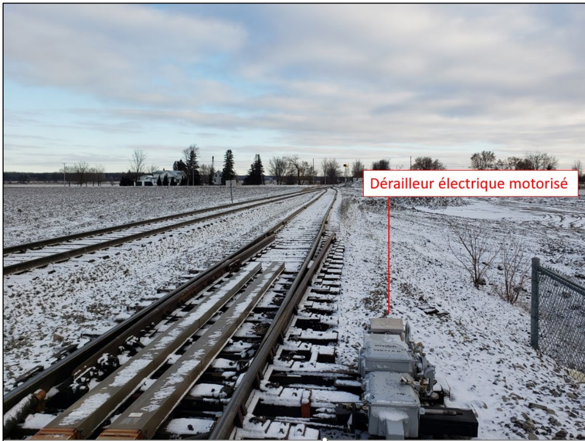
Figure 7. Dérailleur de la voie d'évitement Carr à la gare White (Source : BST)
