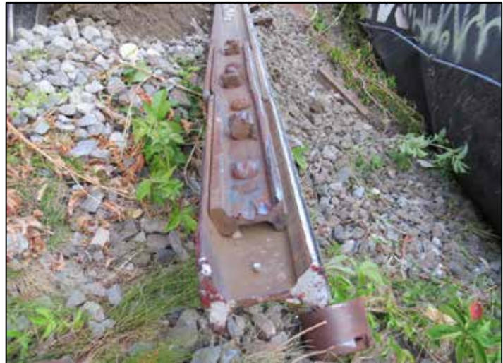
Figure 3. Rail rompu de la voie CC Long Siding
