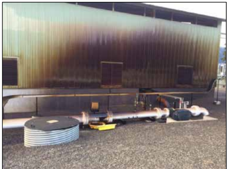
Figure 2. Pétrole projeté sur la face de bâtiment des pompes (Source : Trans Mountain)
